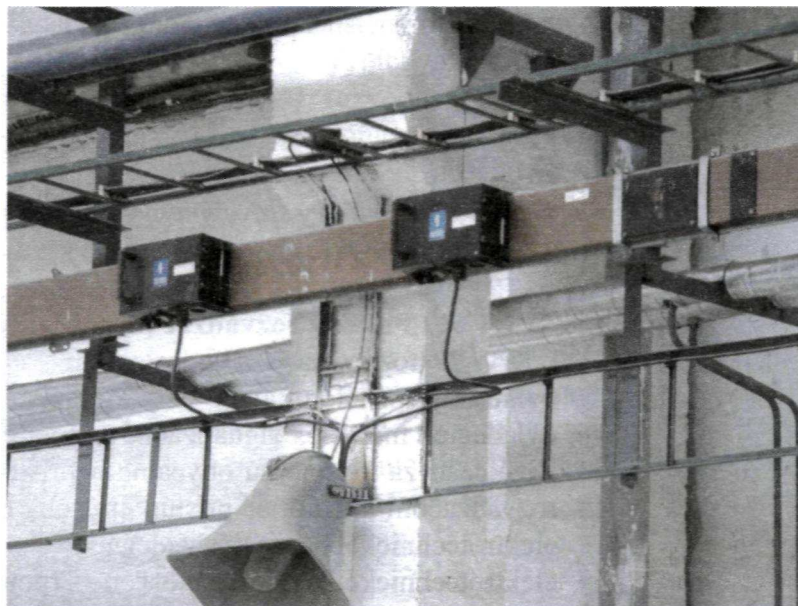
Obr. 15.7 Krytý prípojnicový rozvod
