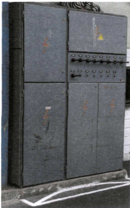
Obr. 15.5 Skriňový stavebnicový rozvádzač
